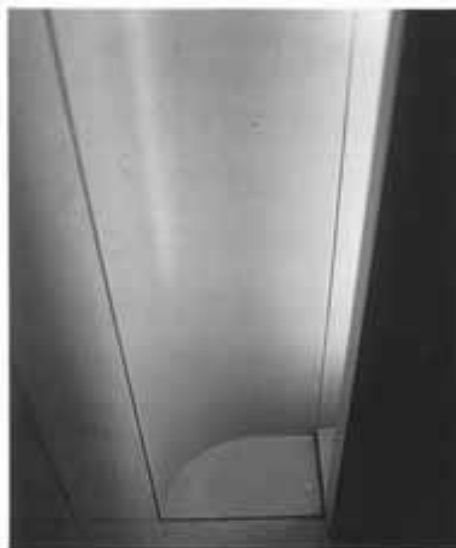
圖 4-23. 加裝反射板增加燈板照明的光輸出量。(香港恆豐酒店)
