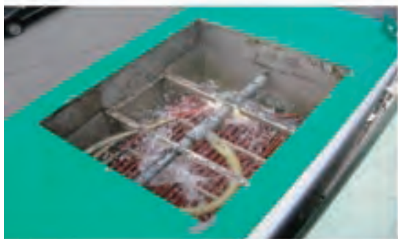
蒸筒式冰水機頂部「淋水冷卻」照片（螺銅冷凝器）。
