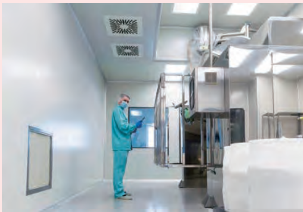
冷凍空調技術在潔淨技術中的應用具非常關鍵的地位。
