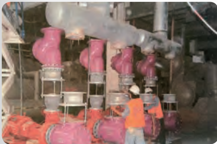
南科奇美工廠冰熱水機房。
