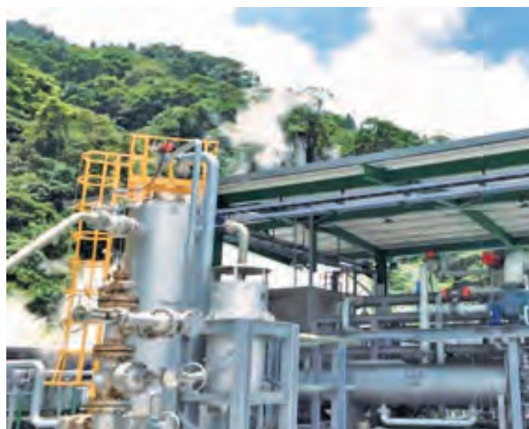
台電仁澤地熱使用漢力能源科技ORC 840kW發電機組，將地熱轉換成電力，其膨脹機頭為漢鐘雙段渦輪機。
