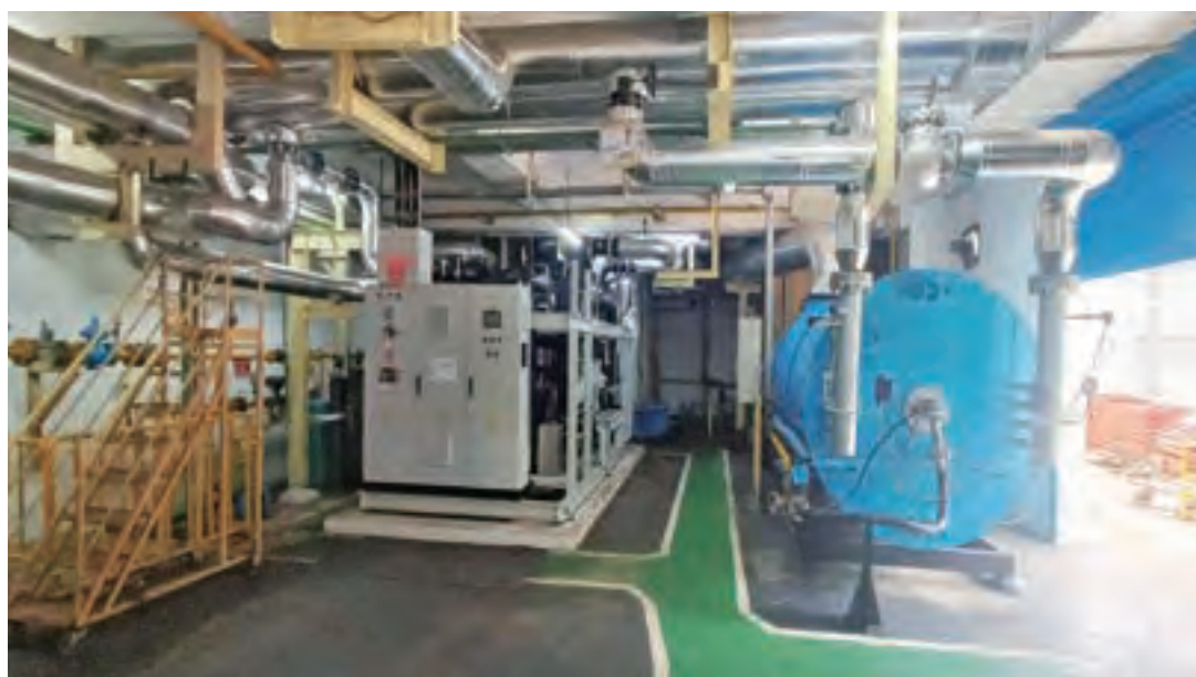
圖為一台安裝在印度某車廠的319kW冷熱雙效高溫熱泵，使用R134a冷媒，熱出水溫度為90°C，冰水出水為7°C，使用漢鐘雙段螺旋式壓縮機，該熱泵是用來取代原本案場的其中一台燃氣鍋爐，熱水用在噴塗製程前的工件脫脂，冰水用在辦公室的舒適空調。冷、熱雙效將能源效率做到極致。
